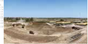
Usine d'épuration d'eau et les canalisations de transfert de la ville Al Nassiriya
